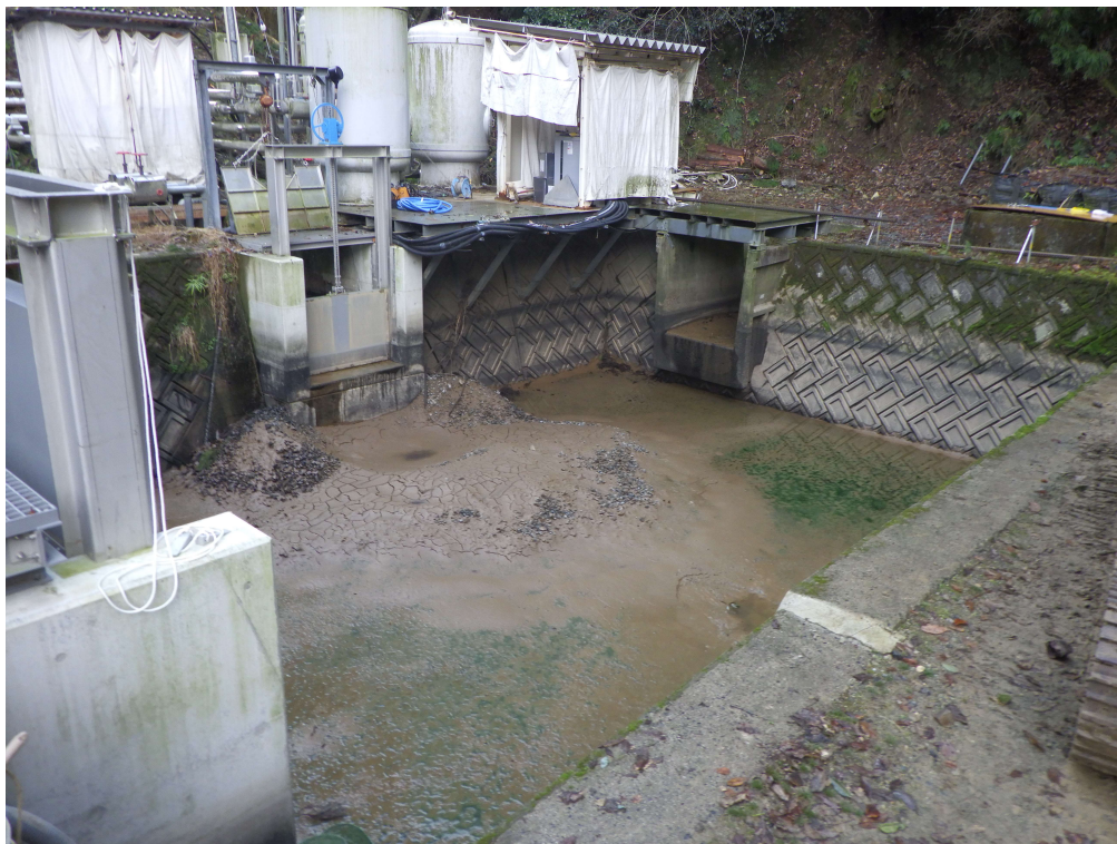
沈砂池 土砂撤去前
