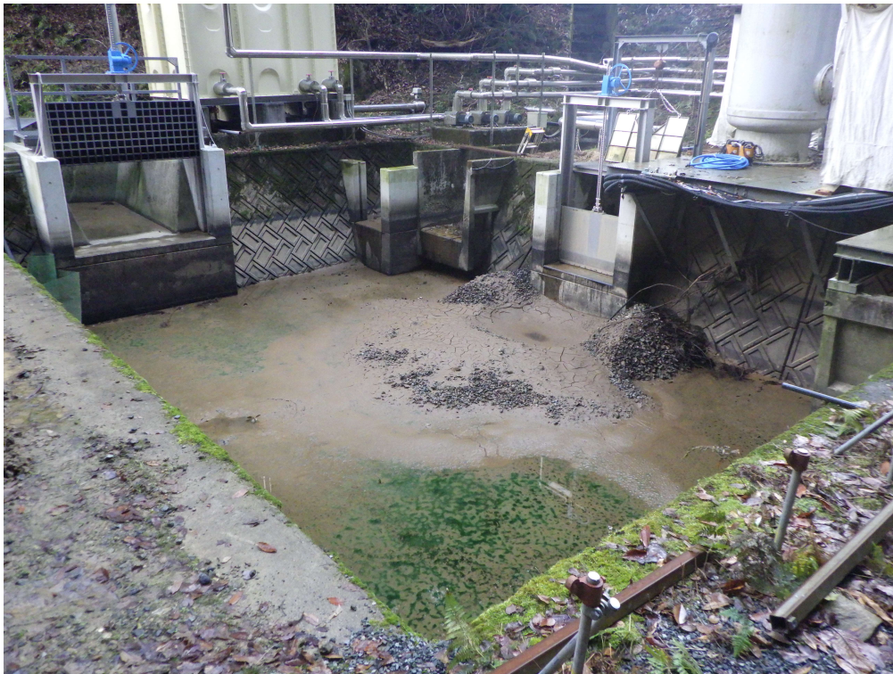
沈砂池 土砂撤去前
