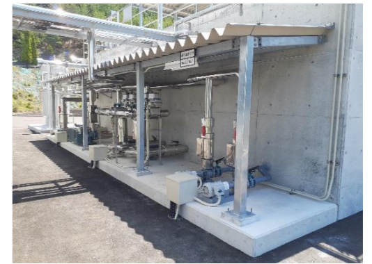
砂ろ過ポンプ、ヒ素原水ポンプ
