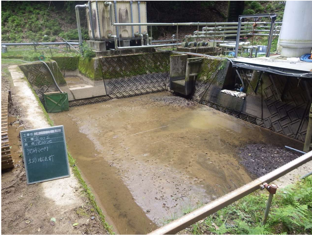
沈砂池 土砂撤去前
