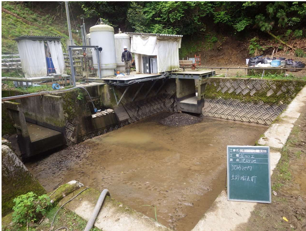
沈砂池 土砂撤去前
